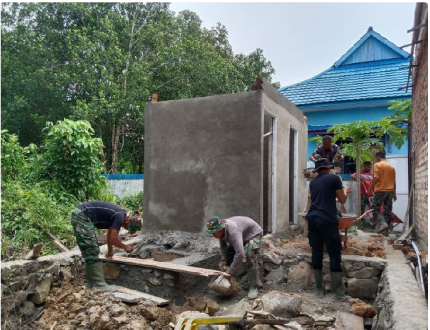
Satgas TMMD ke- 118 Wiltas Kodim 0910/Malinau Progres Pembuatan Septic tank MCK Gereja
